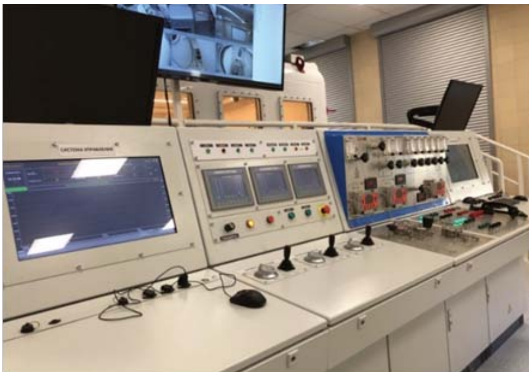
Рис. 14. Панели автоматизированной системы контроля и управления
